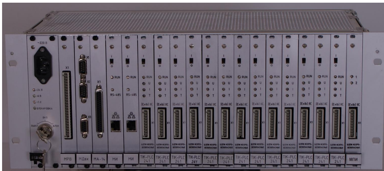
Рисунок 1 – Внешний вид крейта с вспомогательными модулями и контроллерами ТИК-PLC
